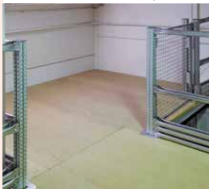
Suelo de tableros de aglomerado machihembrados.
