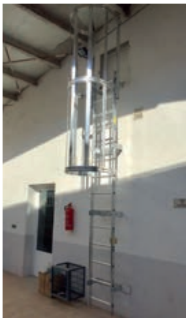
Acceso vertical en uso interior
