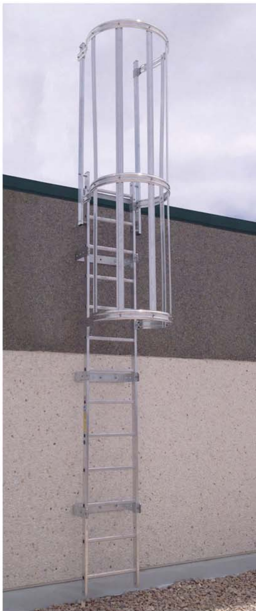
Instalación para acceso a tejado
