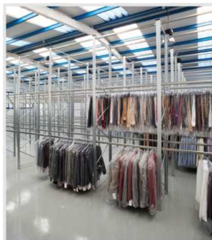
Almacenes de prendas y textil. Módulos con 3 niveles de carga para aprovechar la altura del espacio.
